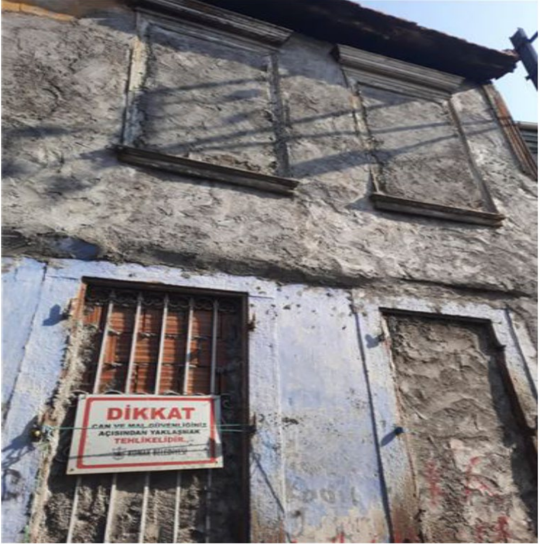
Şekil 4.12 Semtte çökme tehlikesine dair uyarı konulmuş ve ev sahipleri tarafından başkalarının kullanımını engellemek amacıyla pencere ve kapısı beton ile örtülmüş bir ev, 2021, (Kılıç,2023).
