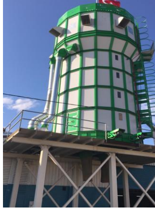
Şekil 3.1 Atık silosu [Foto M. TÜRK].
