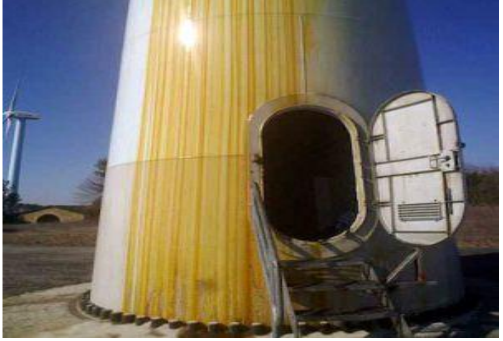
Şekil 4. Yağ sızıntısı, Clyde[26].
