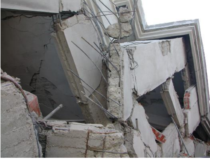
Şekil 4.3 : Kolon-Kiriş Bağlantı Noktalarındaki Zayıflığa Bir Örnek [42].
